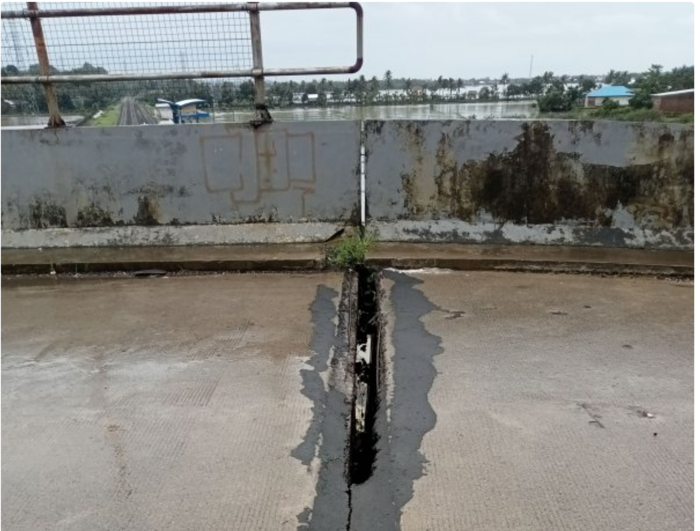
Sambungan jalan fly over Pekkae rusak parah
